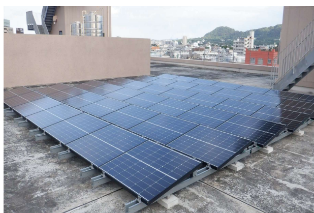
【太陽光発電設備（八重山支店）】
